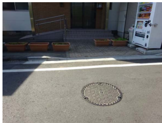
雨水管のマンホール
